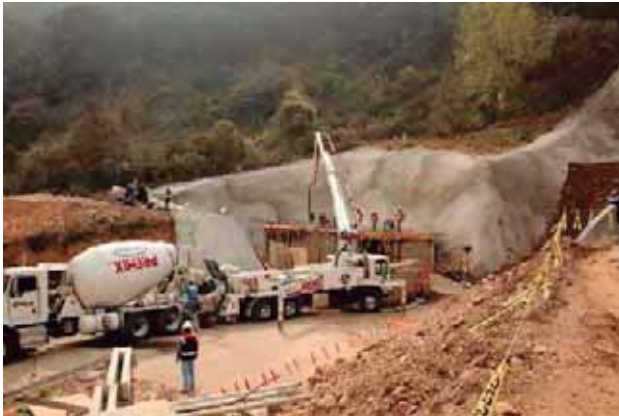
Fig. 80. Concreto lanzado en losa de cuarto de máquinas. Fuente: foto tomada por autor.
