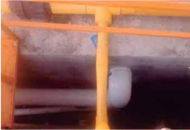
Fig. 83. Tubería en casa de máquinas. Fuente: foto tomada por autor.
