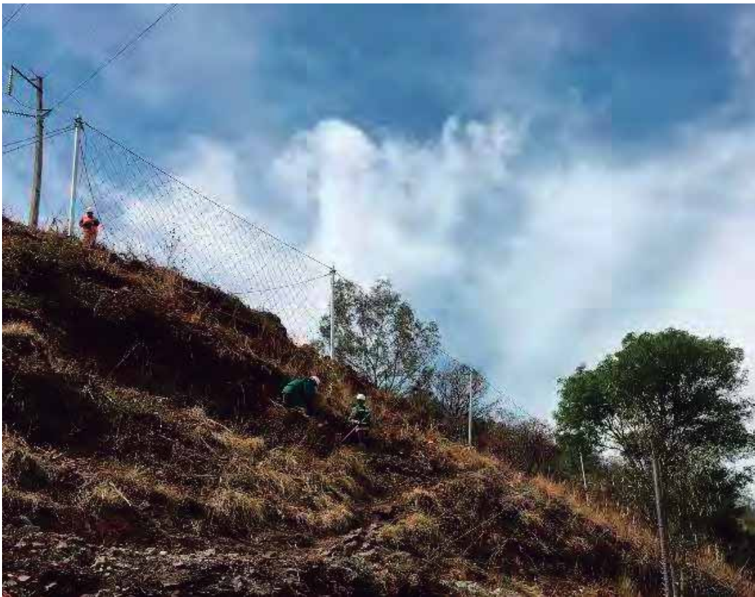
Fig. 91. Finaliza montaje de barrera dinámica. Fuente: foto tomada por autor. 25 de abril de 2016.
