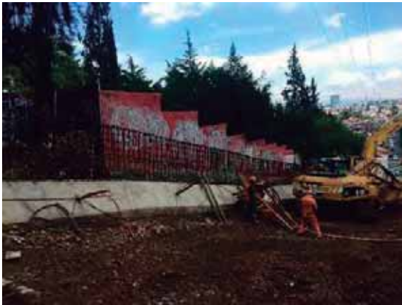
Fig. 44. Armado de acero en muro. Fuente: foto tomada por autor. 14 de julio de 2016.
