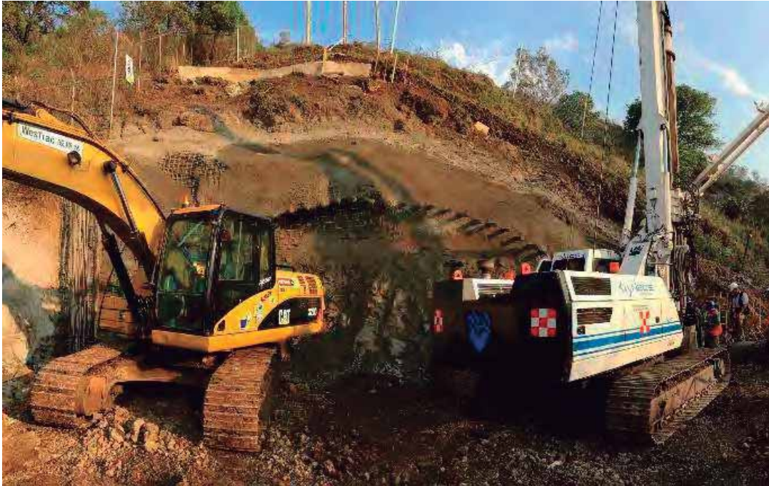
Fig. 34. Lanzado de primera capa de concreto y trabajos de pilotes. Fuente: foto tomada por autor. 01 de junio de 2016.
