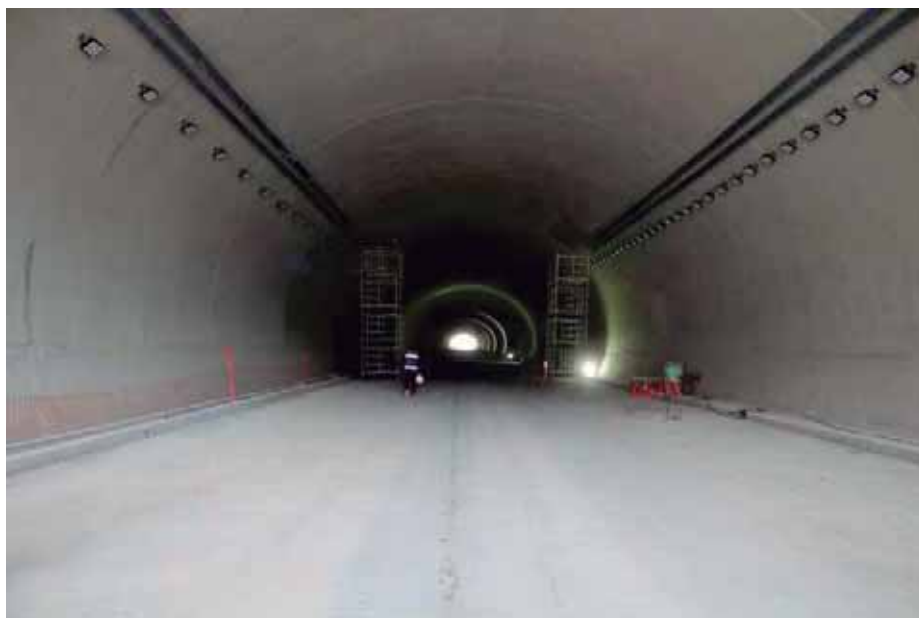
Fig. 81. Colocación de instalaciones especiales. Fuente: foto tomada por autor. 27 de octubre de 2018.
