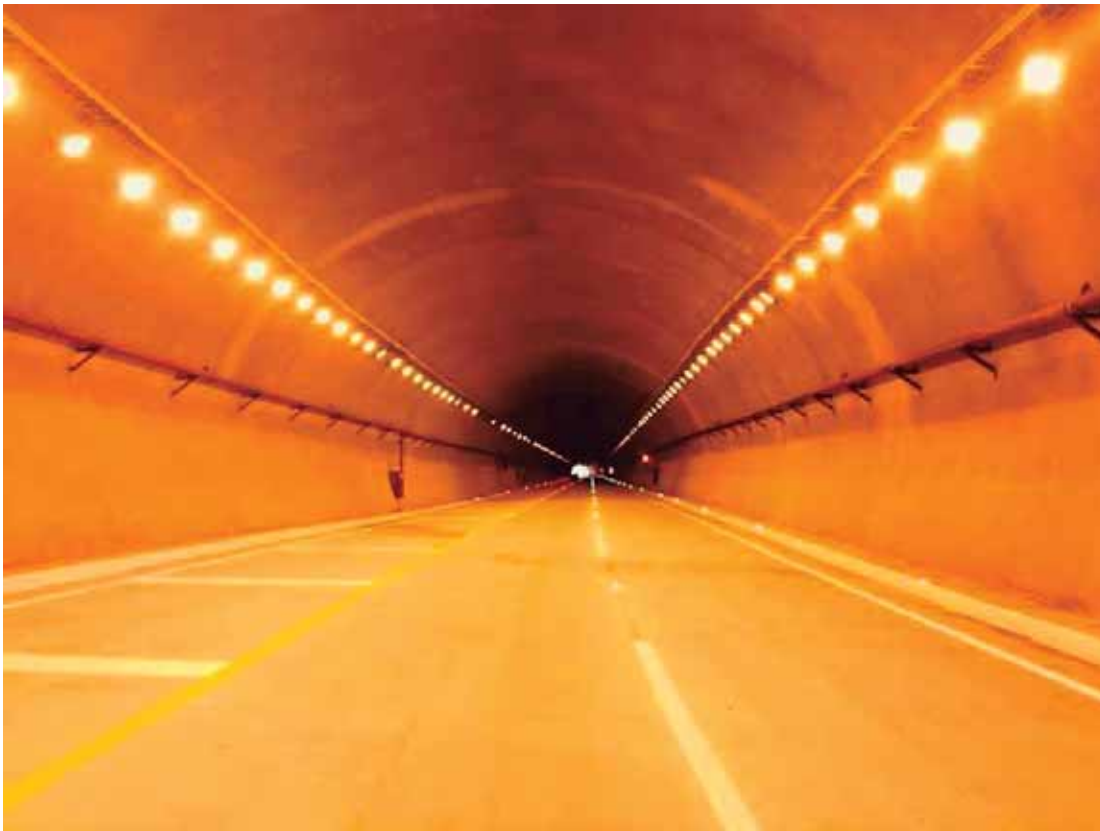
Fig. 10. Ramal Camelinas, iluminación. Fuente: foto tomada por autor.
