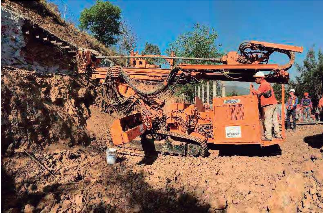
Fig. 32. Perforación de micropilotes de primer enfilaje. Fuente: foto tomada por autor. 17 de mayo de 2016.
