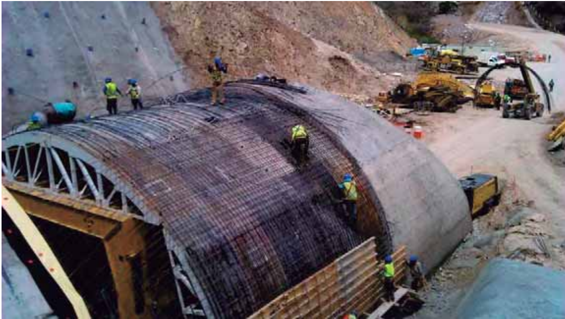
Fig. 63. Armado de acero y colado en túnel. Fuente: foto tomada por autor. 12 de abril de 2017.
