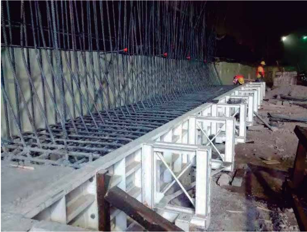
Fig. 61. Armado de acero, cimbra y colado en zapata túnel. Fuente: foto tomada por autor. 08 de abril de 2017.
