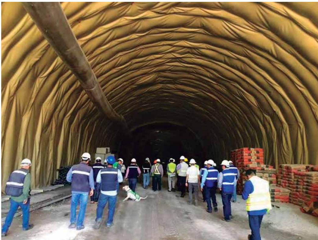
Fig. 49. Geomembrana interior del túnel. Fuente: foto tomada por autor. 06 de septiembre de 2016.
