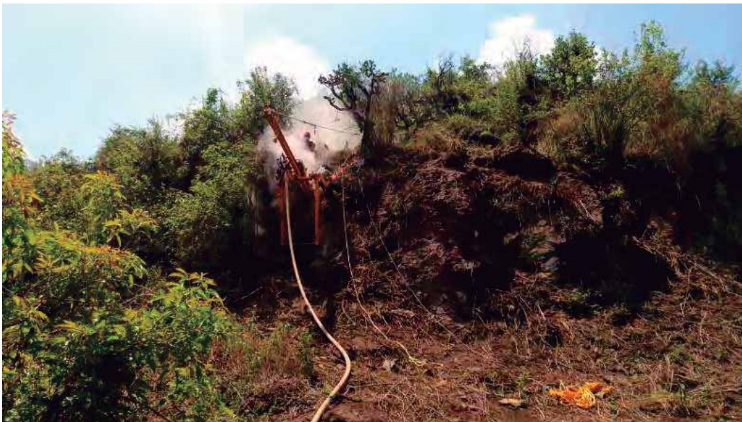
Fig. 37. Anclaje de macizo rocoso frente a secundaria 77. Fuente: foto tomada por autor. 13 de junio de 2016.
