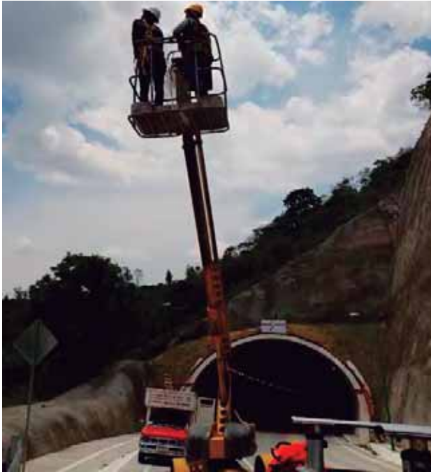
Fig. 92. Señalización y luminaria. Fuente: foto tomada por autor. 23 de abril de 2019.
