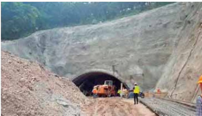
Fig. 58. Excavación de túnel, micropilotes. Fuente: foto tomada por autor. 06 de septiembre de 2016.
