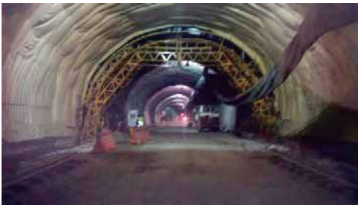
Fig. 60. Geomembrana en túnel. Fuente: foto tomada por autor. 18 de septiembre de 2016.
