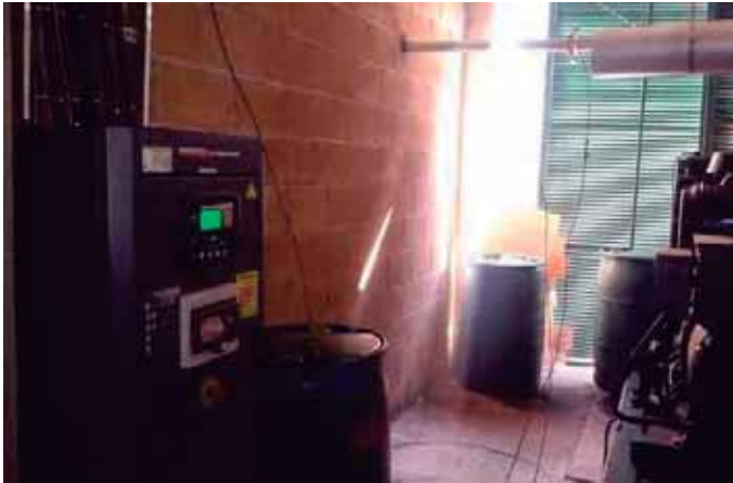
Fig. 88. Instalaciones en cuarto de máquinas. Fuente: foto tomada por autor. 16 de enero de 2019.
