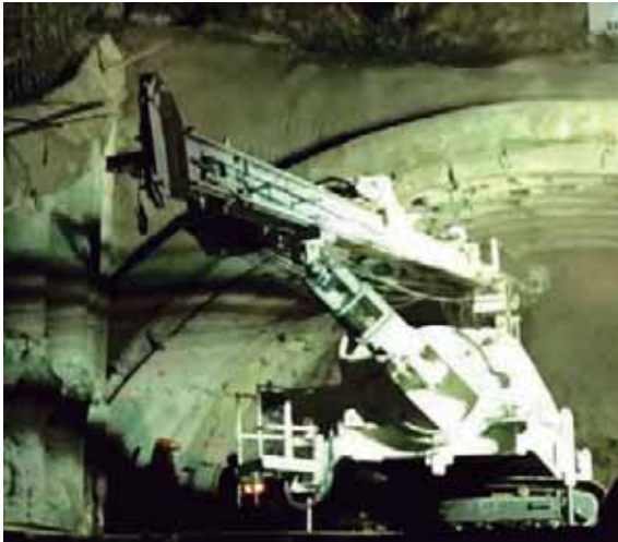
Fig. 38. Inicio de perforación en túnel. Fuente: foto tomada por autor. 12 de julio de 2016.
