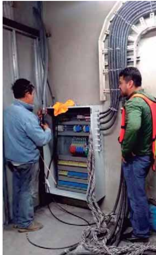
Fig. 86. Instalación especial para túnel. Fuente: foto tomada por autor. 15 de enero de 2019.
