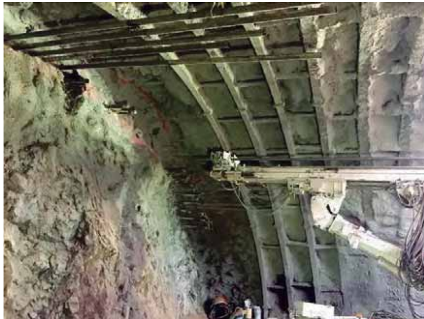
Fig. 43. Excavación de túnel, perforación de micropilotes. Fuente: foto tomada por autor. 14 de julio de 2016.
