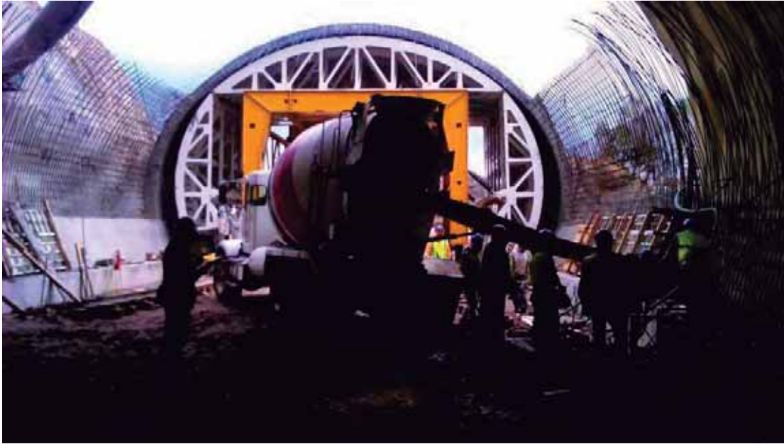
Fig. 67. Habilitado y armado de túnel. Fuente: foto tomada por autor. 09 de abril de 2017.
