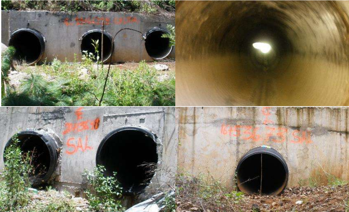
Figura 5. Se muestran tubos corrugados de polietileno de alta densidad sobre cuerpo existente, como complemento a la definición anterior.
