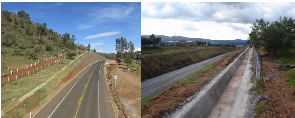
Figura 9. Se muestran las contracunetas construidas aguas arriba de un corte, como complemento a la definición realizada en los párrafos anteriores.
