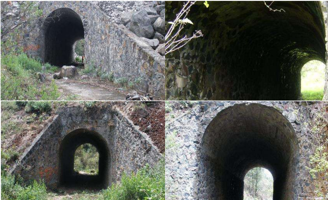
Figura 8. Se muestra bóveda de concreto ciclópeo sobre cuerpo existente, como complemento a la definición anterior.
