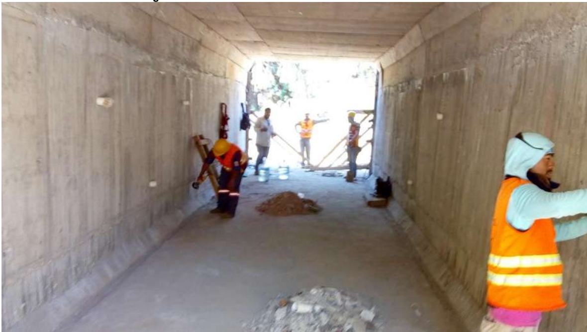
Figura 68. Limpieza de muros laterales e instalación de los drenes de pvc sobre los coples que se dejaron en el cimbrado.
