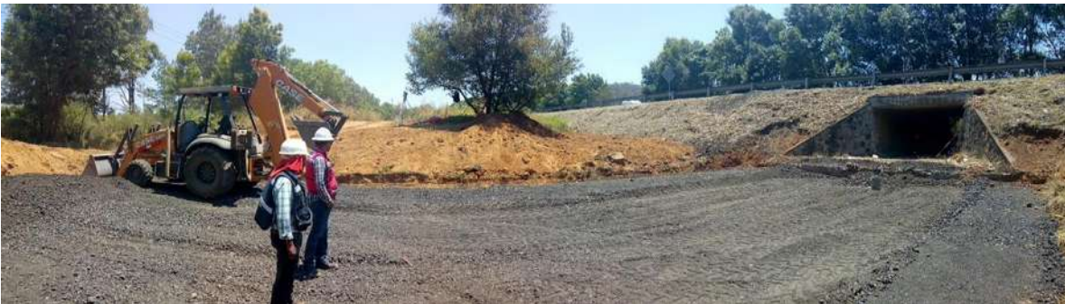
Figura 52. Trazo del eje de la obra de drenaje y mejoramiento del desplante.
