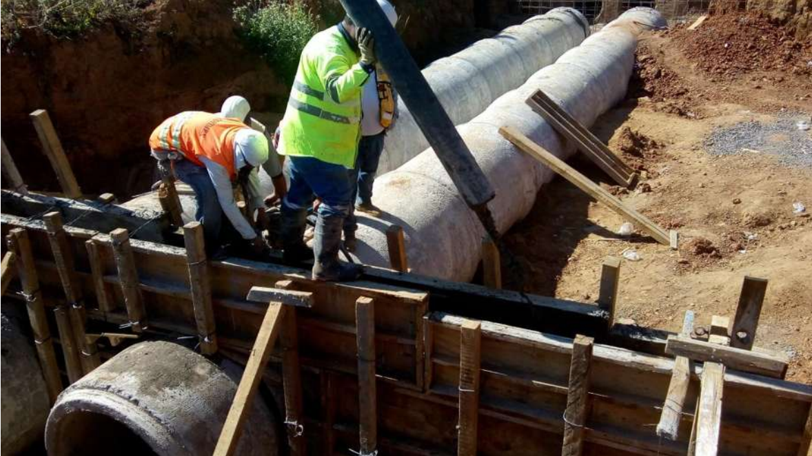
Figura 74. Se realiza el habilitado de la malla de acero, cimbrado y colado de cabezote.
