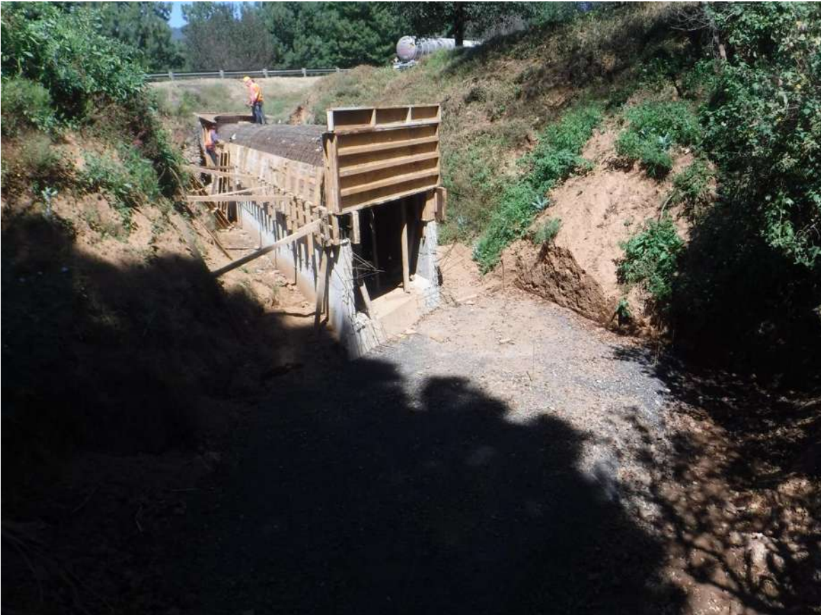
Figura 31. Para el caso de la bóveda se realiza el cimbrado con madera dando la geometría, el habilitado de la parrilla de acero de refuerzo y las correspondientes calzas para garantizar el recubrimiento del acero.
