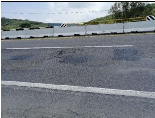
Figura 1. 67 Asfalto deteriorado del puente Las Tórtolas. (Granados Ceras, 2020).
