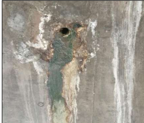
Figura 1.42 Manchas en Losa de concreto. (Granados Ceras, 2020).
