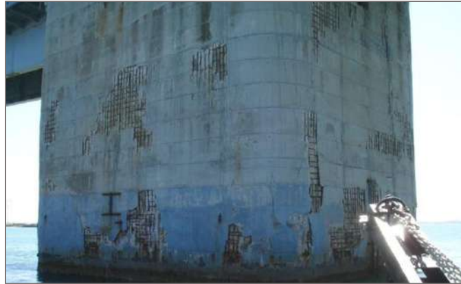
Figura 1.41 Desconchamientos en pila. (SCT S. , Manual de Conservación de Puentes, 2018)
