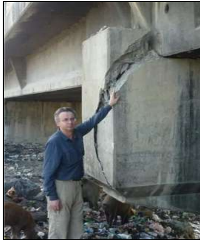
Figura 1. 32 Daños en apoyos de concreto por sismo. (Hernández Quinto & Campos de la fuente , 2008).
