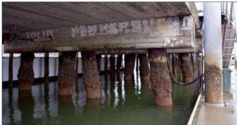
Figura 1.36 Pilas con presencia de sulfatos. (David, s.f.).
