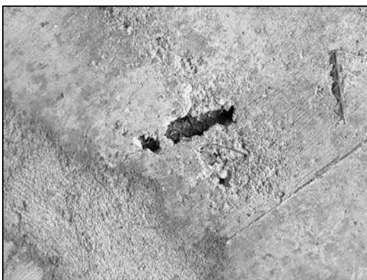
Figura 1. 69 Acero expuesto en losa del puente Las Tórtolas. (Granados Ceras, 2020).
