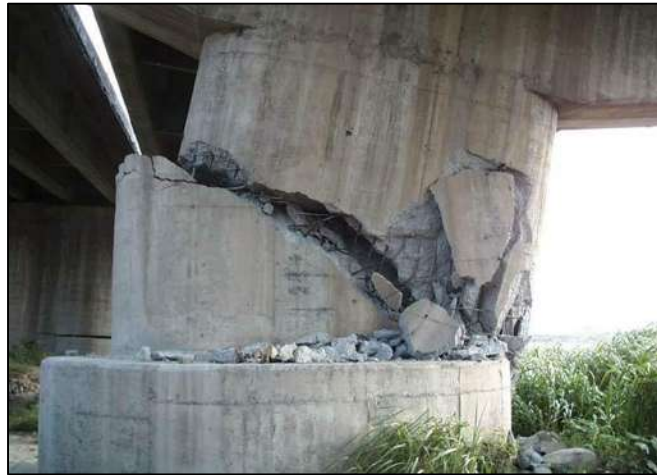
Figura 1. 33 Falla en Subestructura
