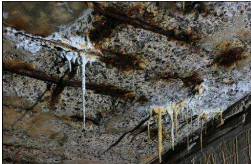
Figura 1.38 Eflorescencia en losa. (David, s.f.).
