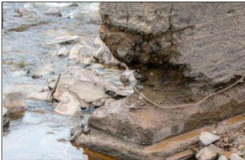
Figura 1.39 Erosión en pila de concreto. (David, s.f.).
