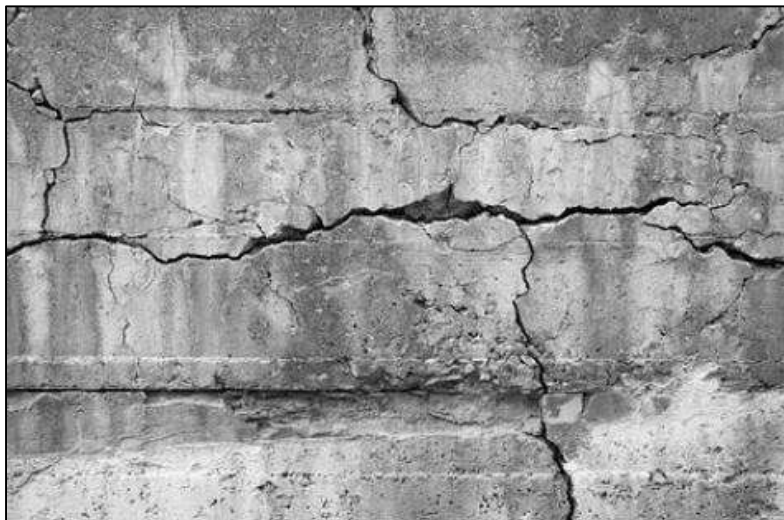
Figura 1.40 Grietas severas en muro de contención. (David, s.f.).
