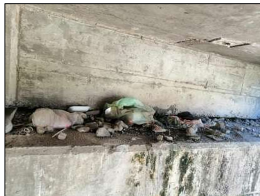
Figura 1.70 Falta de mantenimiento en elementos del puente Las Tórtolas. (Granados Ceras, 2020).
