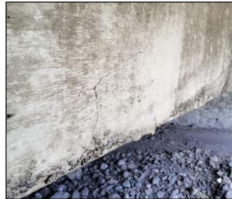
Figura 1. 68 Fisuras en losa del puente Las Tórtolas. (Granados Ceras, 2020)
