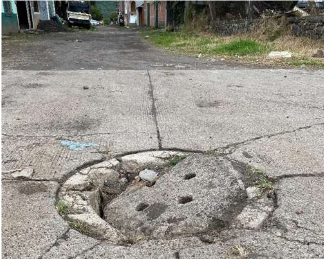
Ilustración 2. Estado de la parte superior de un pozo de visita común
