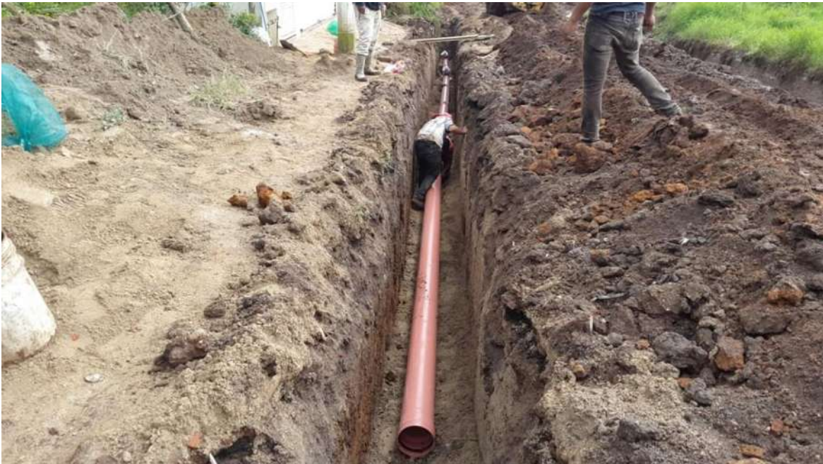
Ilustración 7. Tramo de una atarjea.
