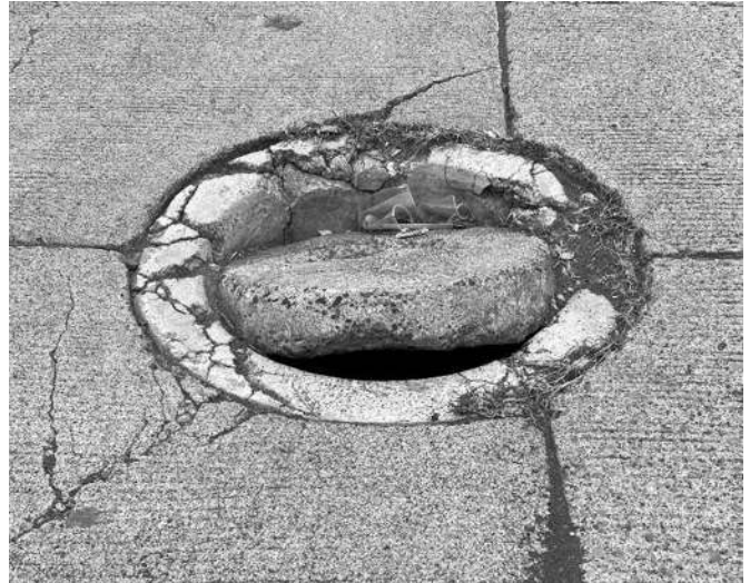
Ilustración 3. Estado de la parte superior de un pozo de visita común
