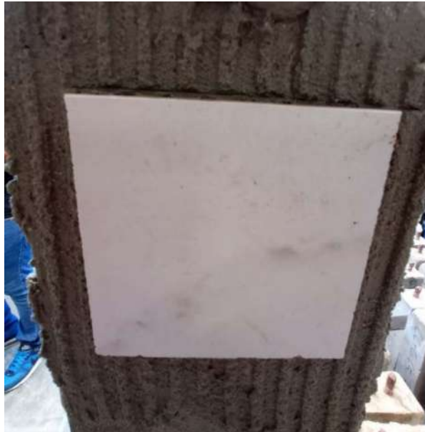
Figura 26. Deslizamiento de loseta cerámica adherida con mortero. (C. A. Díaz Ávila)
