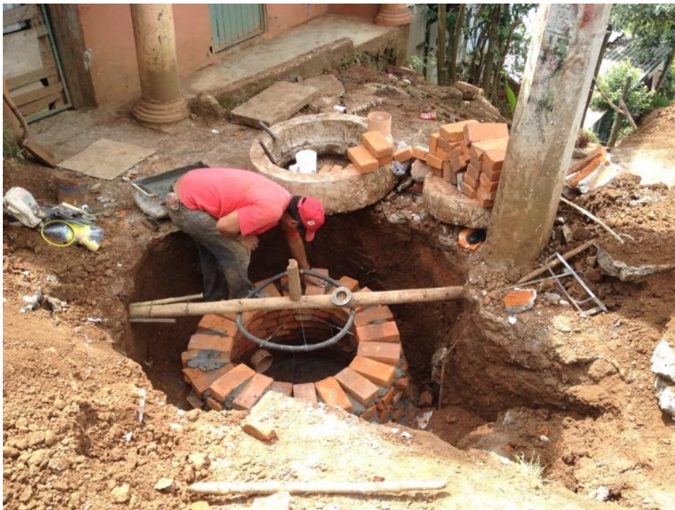
Imagen 6.7 Pozo de Visita con Hecho en Obra
