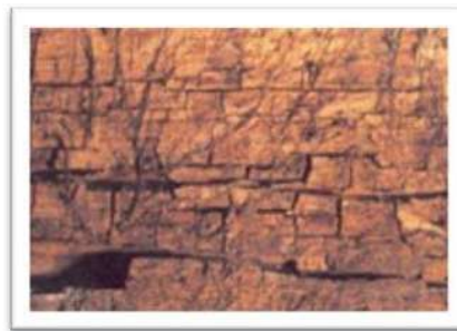
Figura 4. Daños por pudrición parda Fuente: (TEMACSA, 2008)
