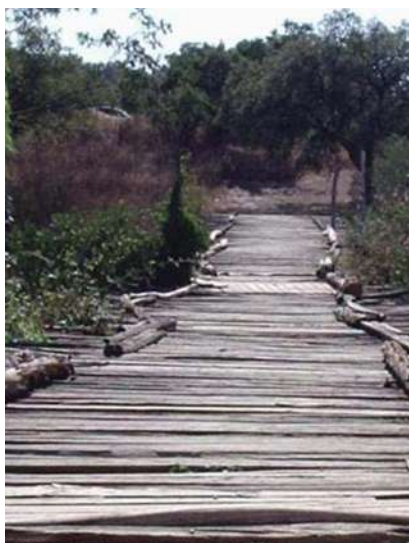
Figura 108. Puentes con desgaste mecánico en la madera. Fuente: (Pinto, s/f)
