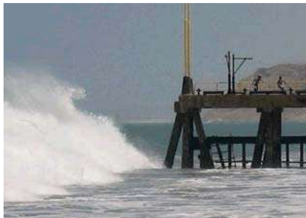
Figura 113. Erosion por oleaje. Fuente: ( Vaca B., 2006)
