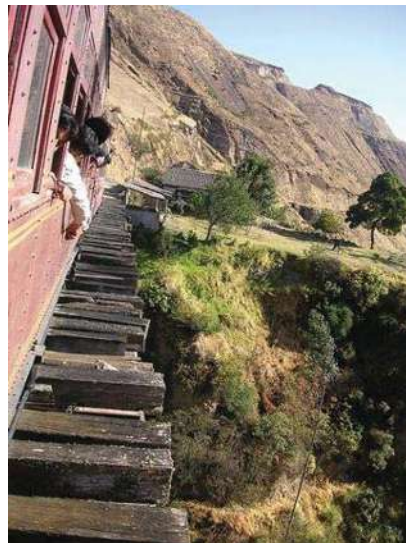
Figura 109. Desgaste mecánico de durmientes. Fuente: (Pinto, s/f)
