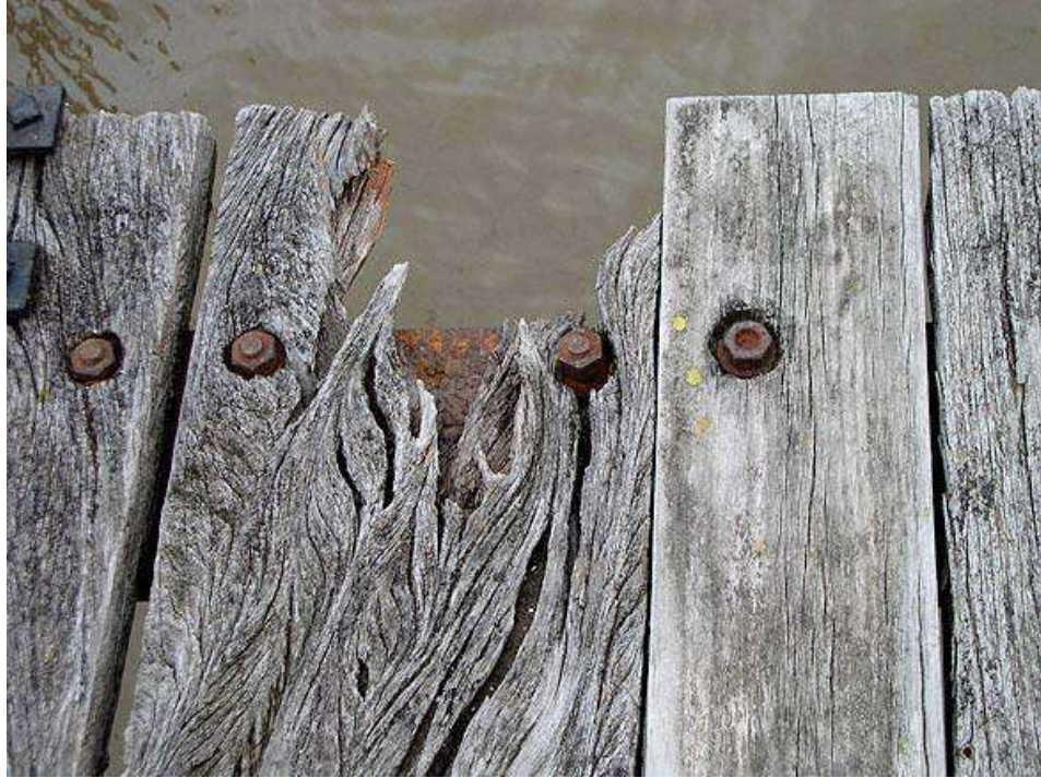
Figura 112. Degradación de madera por radiación solar Fuente: ( Vaca B., 2006)
