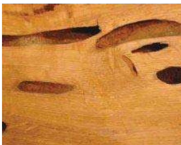
Figuras 55. Daños en madera en uso por Cerambyx cerdo (Linnaeus) Fuente: (CFIA, 2007)
