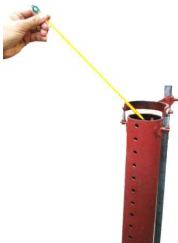
Fig. 6.13. Verificación de temperatura en el tubo de fuego.
