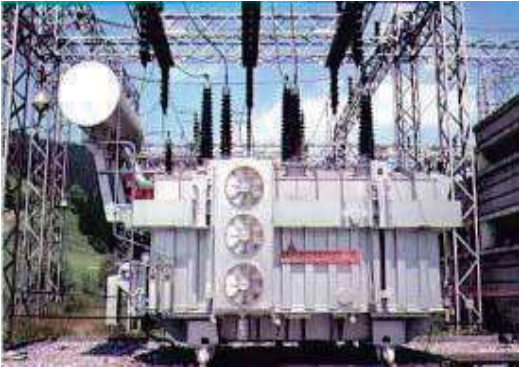
Figura 14: Transformador de potencia
