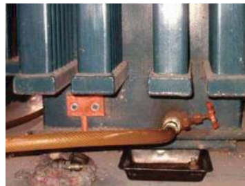
Figura 29: conexión del tanque al equipo de reacondicionamiento
