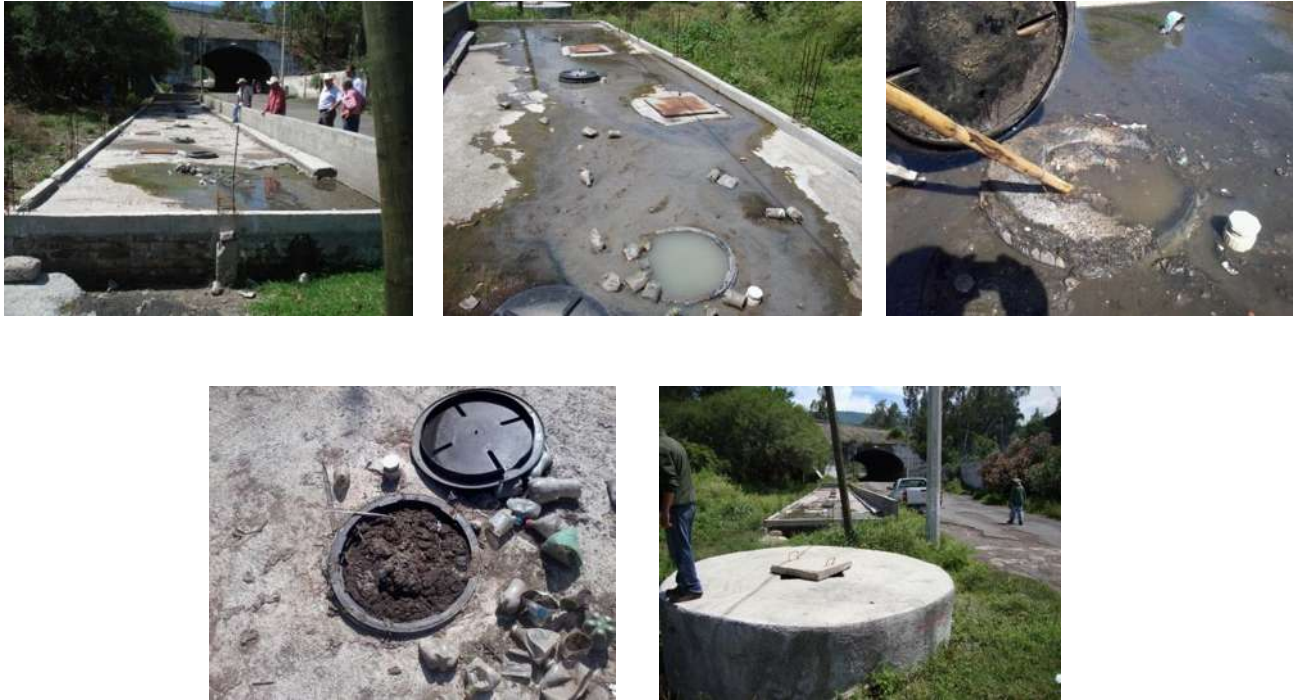
Figura 18.- PTAR San Sebastián.
