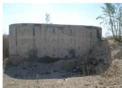
DIGESTOR DE LODOS
