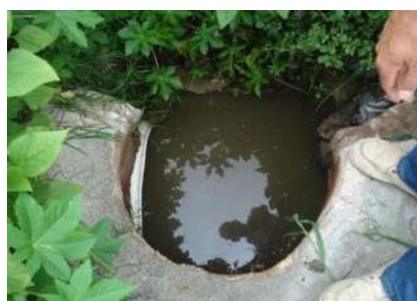
Ingreso de agua residual a la obra inconclusa
