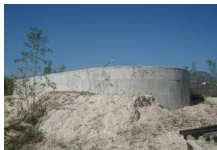
TANQUE DE AIREACION
