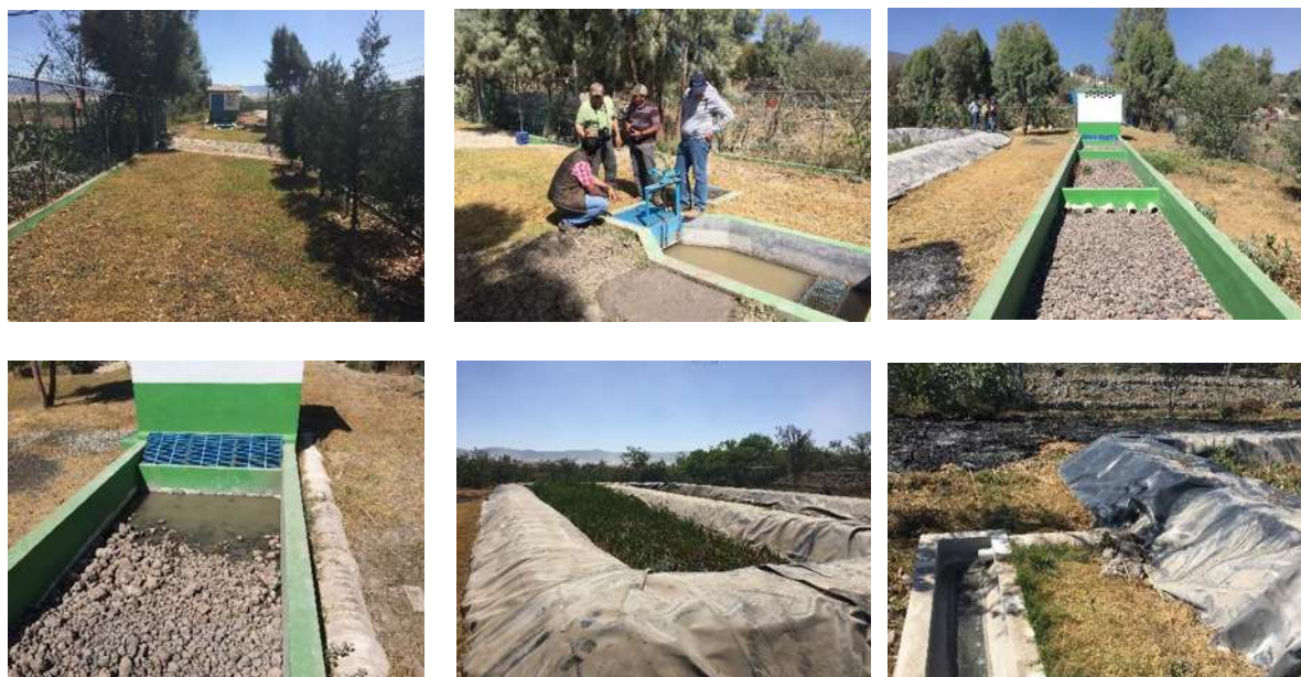
Figura 40.- Sistema después de las modificaciones PTAR Dr. Miguel Silva.
