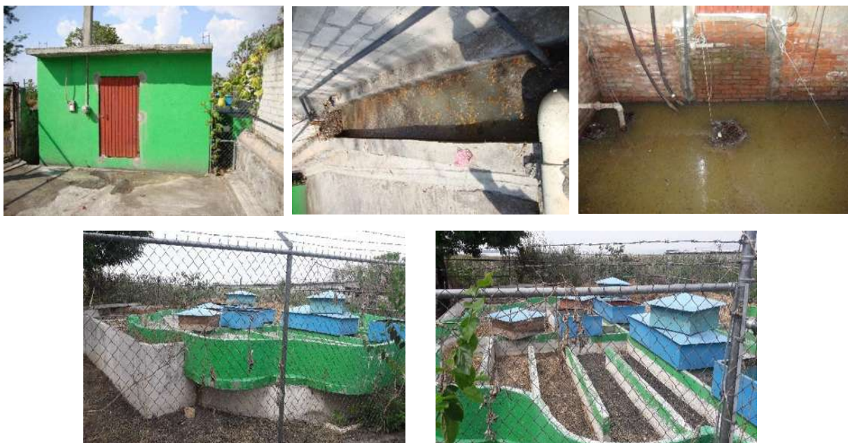
Figura 47.- Sistema antes de las modificaciones PTAR Chehuayo.
