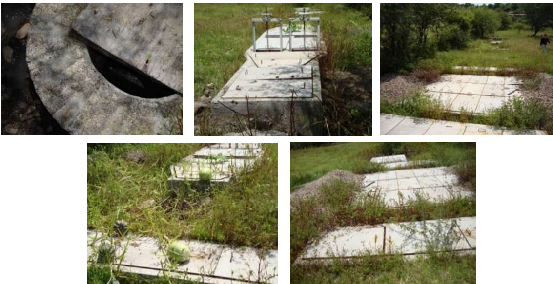
Figura 22.- PTAR de Tupatarillo.
