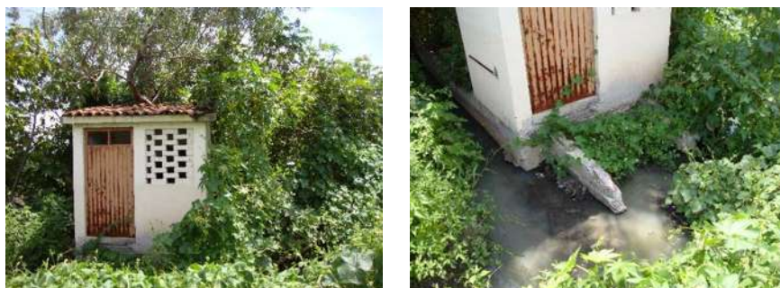
Figura 39.- Sistema antes de las modificaciones PTAR Dr. Miguel Silva.
