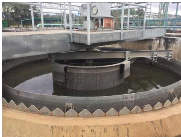
Figura 3.9. Sedimentador o Clarificador de la planta de tratamiento de aguas residuales “San Pedrito”, Pátzcuaro, Mich.
