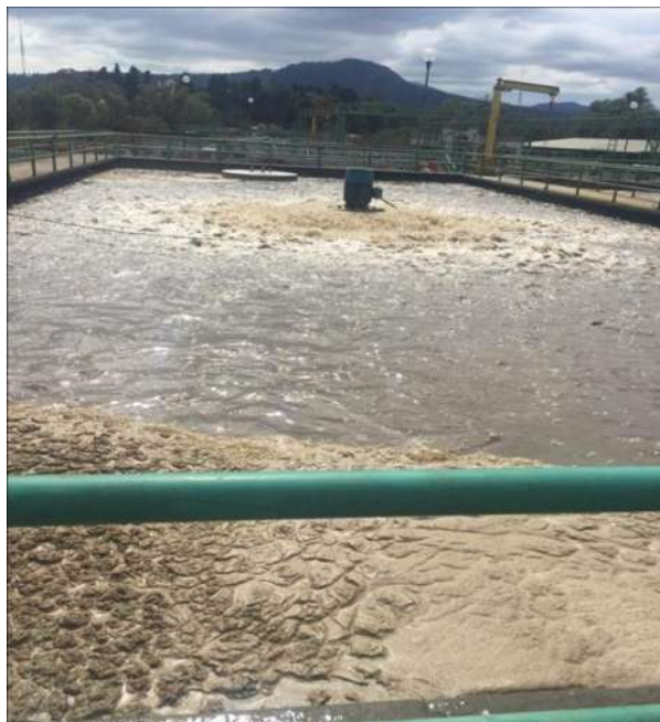
Figura 3.6. Reactor biológico con sistema de aireación superficial de la planta tratadora de aguas residuales “San Pedrito”, Pátzcuaro, Mich.
