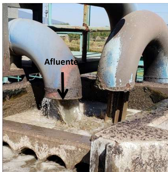
Figura 3.1 Agua de entrada a la planta (afluente)
