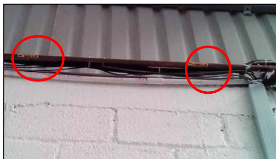
Ilustración 157 Fotografía de implementación de código de colores de tubería
