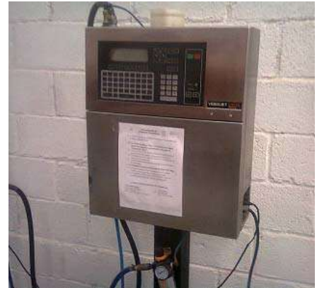
Ilustración 202 Codificadora trabaja con aire comprimido
