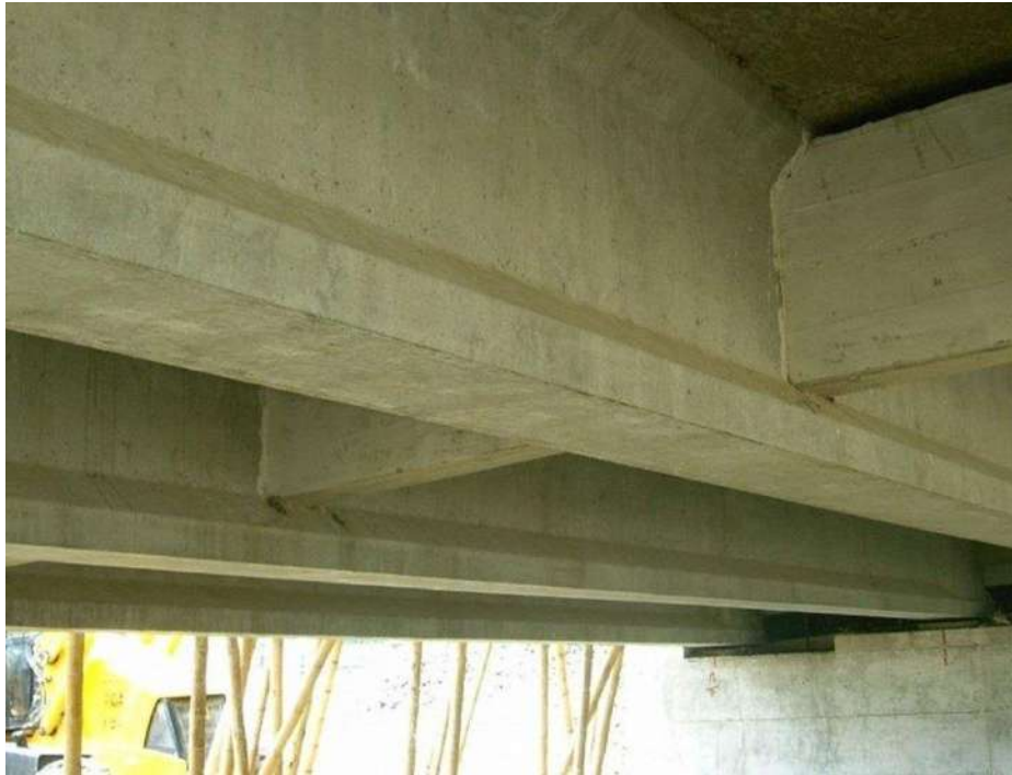
Figura 3.9 Vigas diafragma de concreto. Tomada de https://www.researchgate.net/figure/Diafragma-de-arriostramiento-para-vigas-pretensadas-en-viaducto-Bahia-San-Vicente_fig1_329216784
