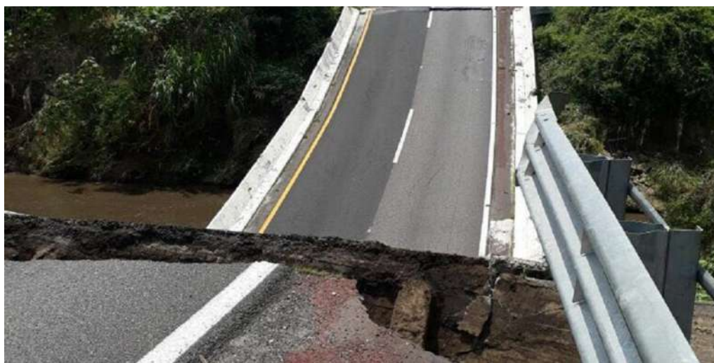
Figura 5.8 Puente derrumbado en carretera Cuernavaca-Acapulco tras sismo del 19/09/2017. Tomada de https://www.razon.com.mx/mexico/tras-sismo-7-1-colapsa-puente-vehicular-en-la-mexico-acapulco/
