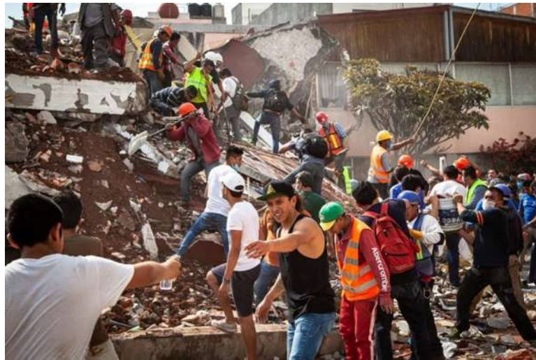
Figura 5.7 Levantamiento de escombros por civiles tras el sismo del 19 de septiembre del 2017. Tomada de https://www.forbes.com.mx/sismo-devastador-de-septiembre-de-2017/
