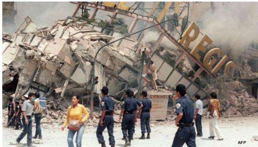
Figura 5.6 Edificio colapsado durante el sismo de 1985. Tomada de https://www.bbc.com/mundo/noticias/2015/09/150917_mexico_sismo_antes_despues_fotos_an
