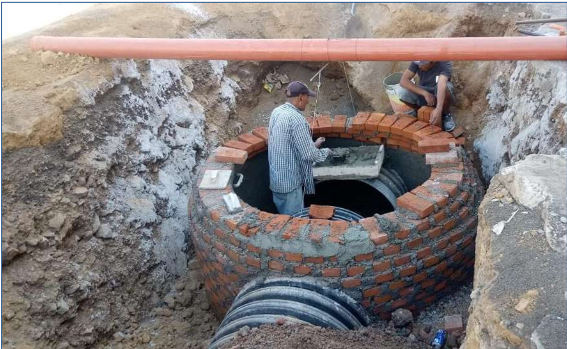
Fuente: Tesista Imagen 11: Pozo de visita
