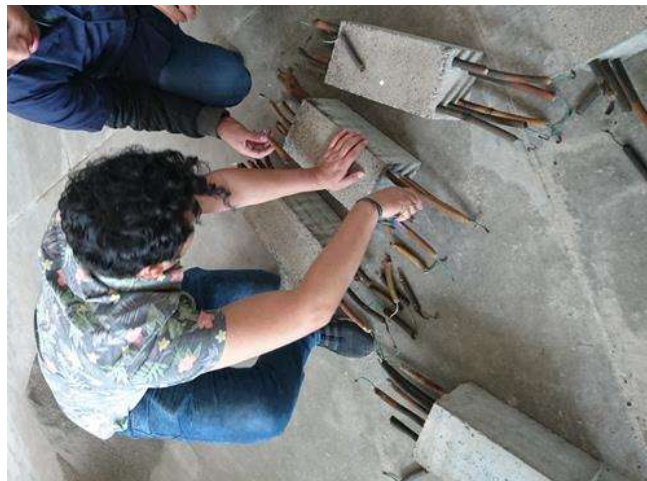
Ilustración 11 Retire de barra aislante sobrante, sin varilla a proteger
