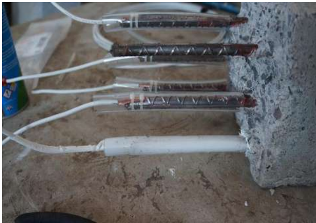
Ilustración 21 Colocación del sellador de protección dentro de la manguera nueva que cubre la varilla limpia.
