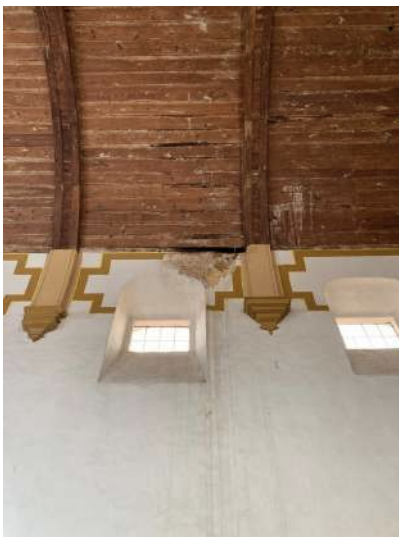
Fig. 56 Faltante de tablón en el arranque del arco visto desde la nave. Fuente: Martínez Cruz, 27.10.21
