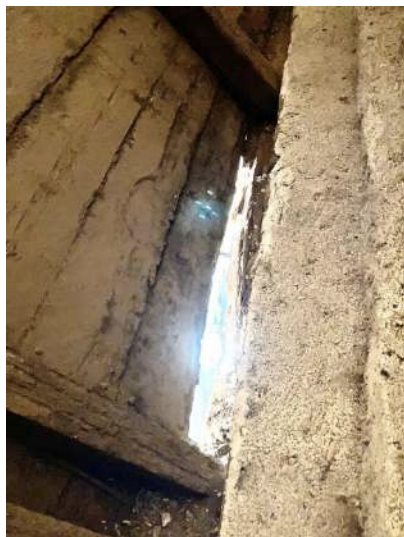
Fig. 55 Faltante de tablón en el arranque del arco. Fuente: Martínez Cruz, 27.10.21
