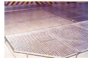
Piso elevado de rejilla
