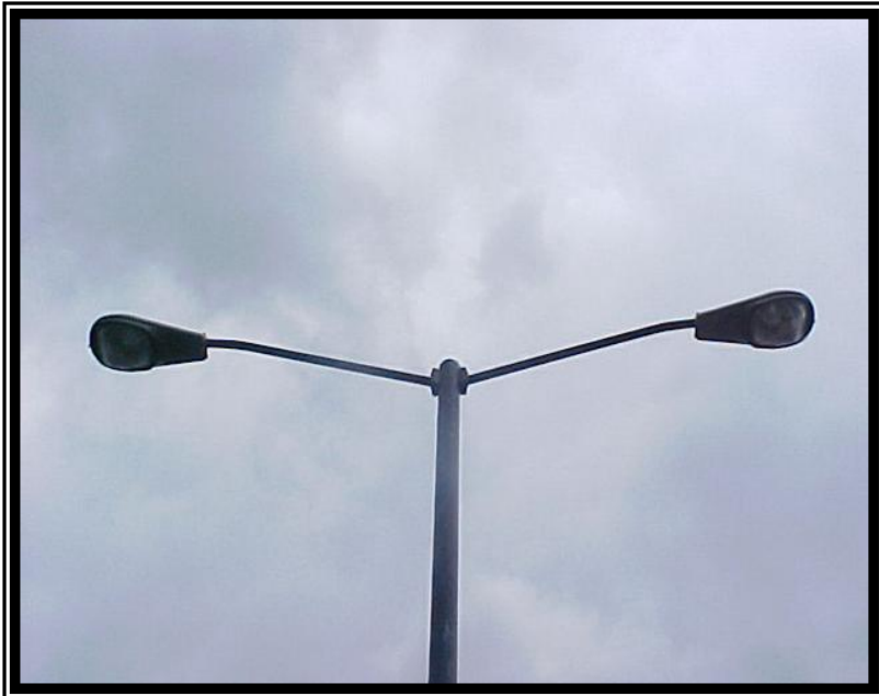
Fig. 12. Poste de Alumbrado Público con doble luminaria arbotante tipo OV-15 de vapor de sodio (Fuente C.F.E.).
