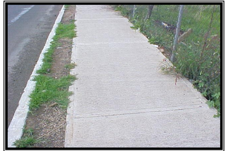
Fig. 13. La banqueta en la que se ubica la tubería es la banqueta colindante con el acceso al terreno. (Fuente OOAPAS).
