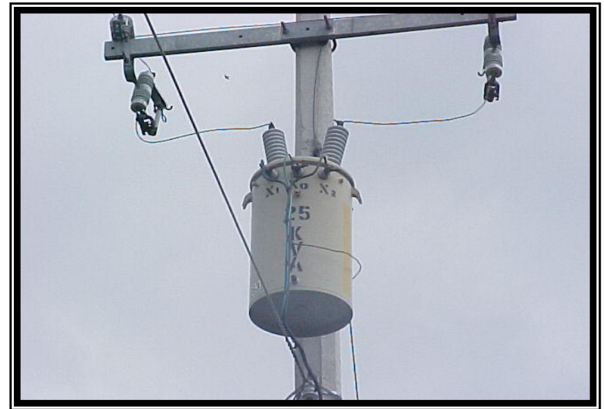
Fig.11. Transformador ubicado en la Av. Universidad frente al terreno en estudio.
