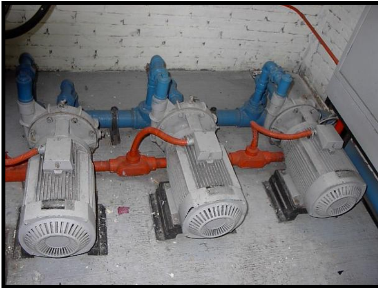
Fig. 5.3. Sistema contra incendio que como se puede ver en la fotografía, consta de tres bombas para proporcionar una presión de agua pulverizada (con polvo), gracias a la ayuda de un hidroneumático que nos proporciona esta presión constante.
