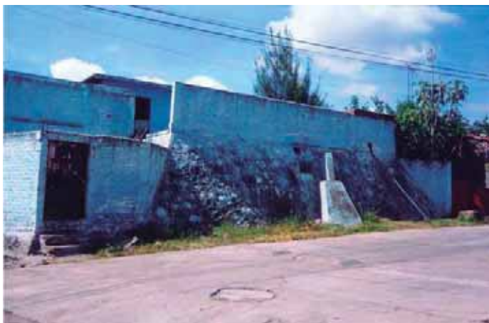
17.- DEPÓSITO DE AGUA POTABLE UBICADO EN EL BARRIO DEL CALVARIO (PRINCIPAL)
