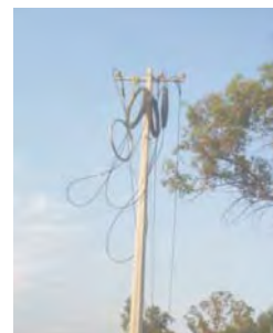
Red existente en la Av. San José del Cerrito
