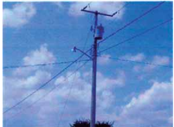
Foto 14. Red de luz eléctrica y alumbrado público.
