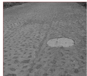
P.85 fotografía de un pozo de visita.
