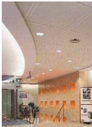
Ilustración 6 Luminarias tipo downlight
