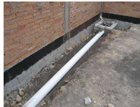
IMAGEN 88/DRENAJE P.V.C 6"/FUENTE: AUTOR TESIS
