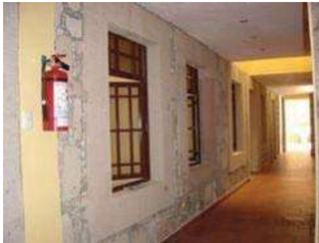
Fig. V21. Vestíbulo con seguridad.
