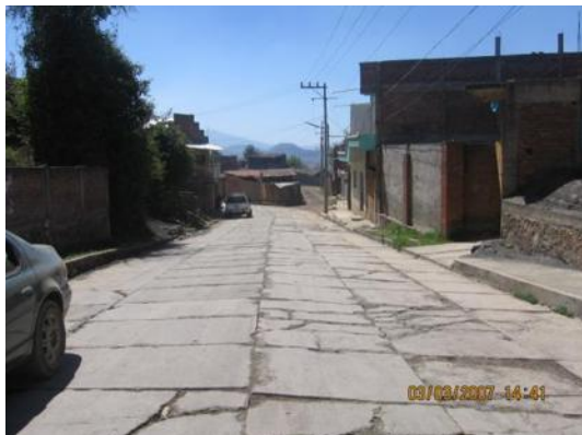
Calle con pavimentación de concreto en mal estado
