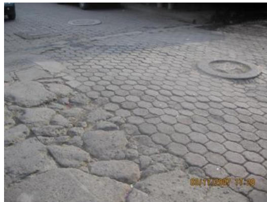
Pavimento deteriorado entre cruce de calles
