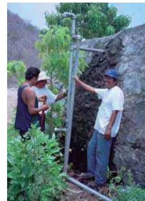
Imagen 38/imagen del mejoramiento de la red de distribución de agua potable en la localidad de Maruata/ fuente: de mis investigaciones y reportes fotográficos en Maruata. 64
