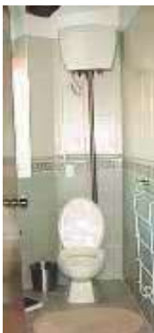
Fig. XIII, Inodoro adaptado con la tubería por fuera
