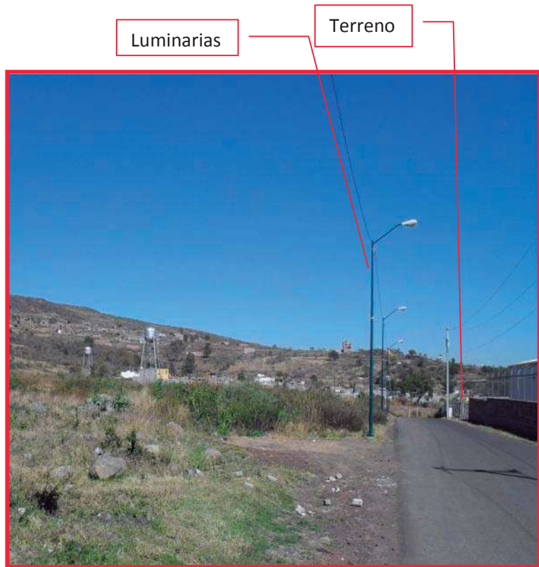
Figura 99. Alumbrado Público dentro de la colonia del terreno. Origen: foto capturada en 2008
