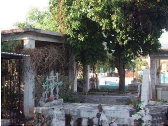
FOTO 3: CPO (2009). Vista del algunas tumbas que se encuentran en mal estado.
