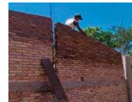
Fig. 74. Adherencia de tabiques en muro. Fotografía de: J. Julio Chávez Hernández.
