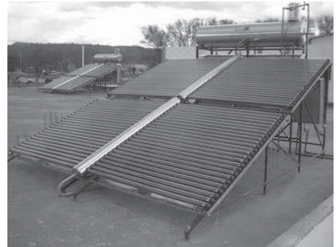
Fig. 51.- Calentador Solar Industrial
