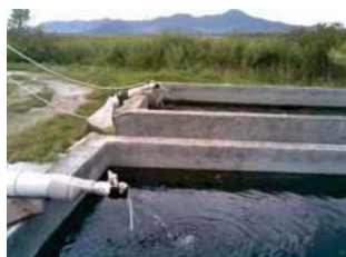
Fig.1.8. Suministro, agua a piletas.
