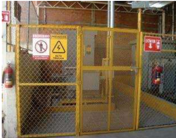
Imagen 45 de una subestación eléctrica en nave industrial 114
