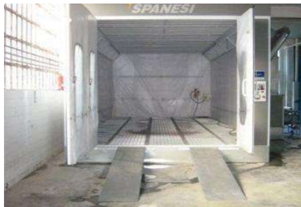
Imagen 78 Cabina de pintura 186
