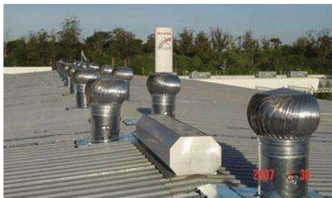
Imagen 50 de extractores colocados sobre la cubierta de una nave industrial 123
