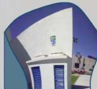
Imagen 118, transformador de luz, el cual se localiza al lado derecho del acceso principal.
