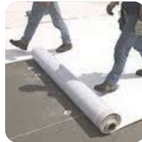
Imagen 4.7 Impermeabilizan te a base de membrana TPO color blanco para el acabo exterior en losa.
