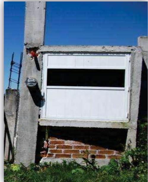
Imagen 3.12 Se muestra que el terreno cuenta actualmente con una línea de energía eléctrica de 120 v para casa habitación. Y existen postes para acometidas en caso de requerir algún otro.
