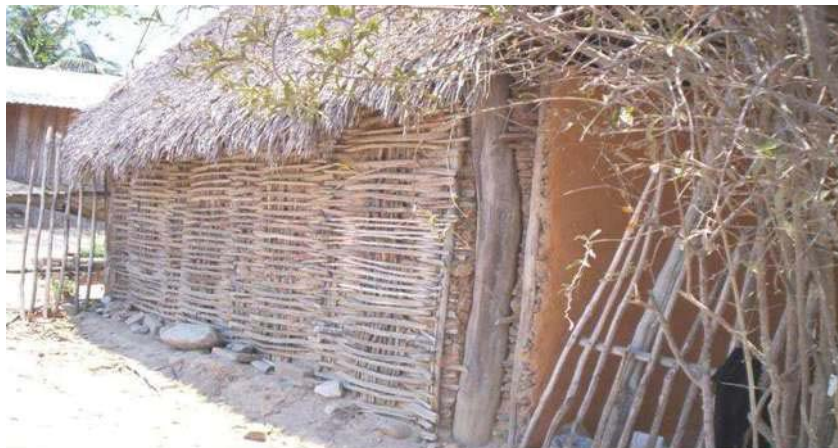
Foto 4.- PEQUEÑA EDIFICACION BASADA EN LOS SISTEMAS CONSTRUCTIVOS DE LA REGION NAHUAT. Fuente: CDI. Centro Coordinador para el Desarrollo de los Pueblos Indígenas, Diagnostico de la Región.
