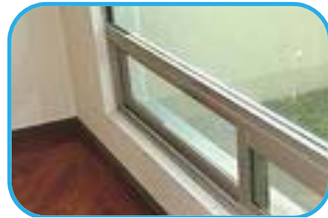
Foto No.16 Ejem. Aislamiento térmico y acústico
