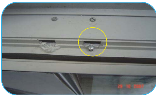
Foto 109 verificar Sellado en tornillos de módulos
