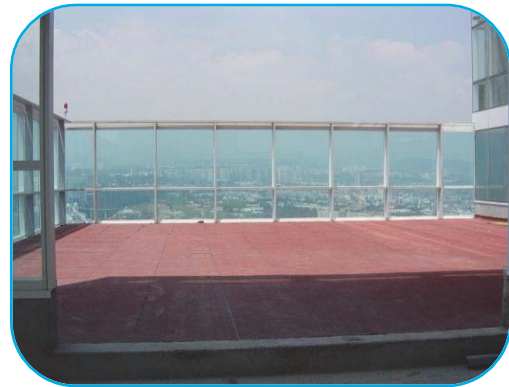
Foto No. 45 Módulos de terraza en azotea
