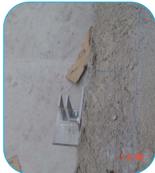
Foto No. 91 Ancla de arranque
