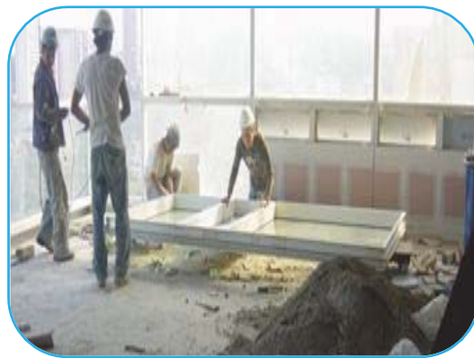
Foto No. 89 ejemplo condiciones inseguras
