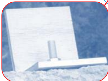
Foto 102 Angulo de Aluminio 41/2" x 3/8" unido al ancla alfen embebido en el concreto
