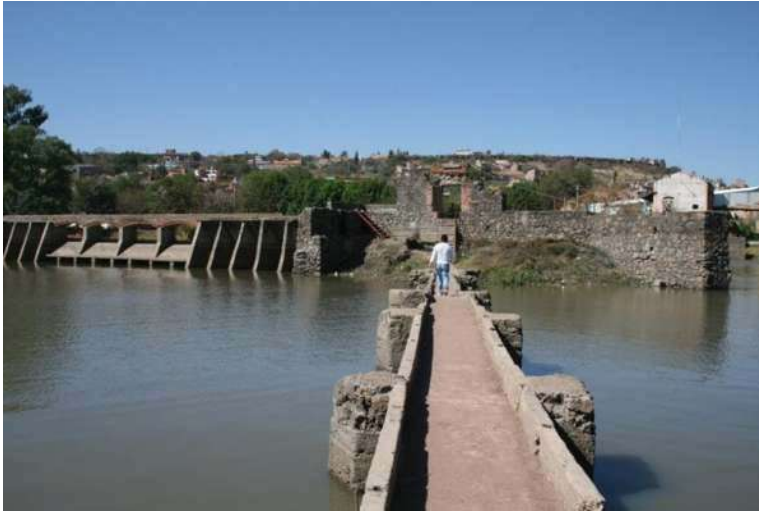
FIG.34. En esta imagen podemos ver como la gente que habita en la comunidad de Santa Ana Pacueco se arriesga atravesando el río por las compuertas. Pero este es su único camino en la parte dur de la mancha urbana para tener acceso hacia la Piedad de manera peatonal. Ya que dentro de esta zona no existe un puente peatonal que fuese proyectado, mientras los habitantes de esta comunidad utilizan esta opción ya que el cruce más cercano se encuentra aproximadamente a dos kilómetros. Haciendo comparación con la imagen derecha el cruce no cuenta con algún barandal que pueda proteger a las personas y evitar que estas puedan tener algún accidente al momento de cruzar. Salvador García. Julio 2009
