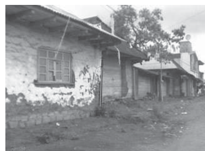
Fig. 3.-Contexto actual de la calle Lázaro Cárdenas, en donde se puede observar la evolución de la arquitectura, a la izquierda un edificio de adobe en desuso y con gran grado de deterioro, al centro una vivienda a base de trojes actualmente habitada y a la derecha las nuevas construcciones con materiales innovadores. Foto: Alfonso Álvarez Sandoval
