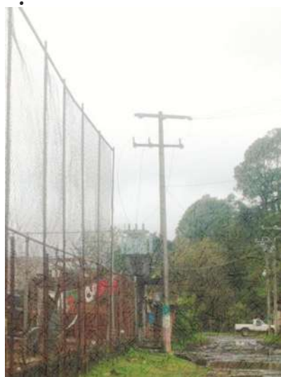
Ilustración 17 Servicio de alumbrado público. Fuente: fotografía tomada por SSD. Septiembre 2010.
