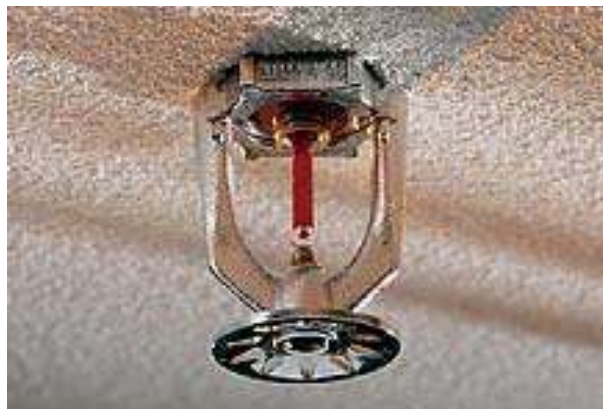
Imagen 27. Aspersor contra incendios
