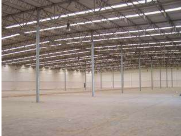
Imagen 33. El concreto es la solución más común para los suelos en la actualidad
