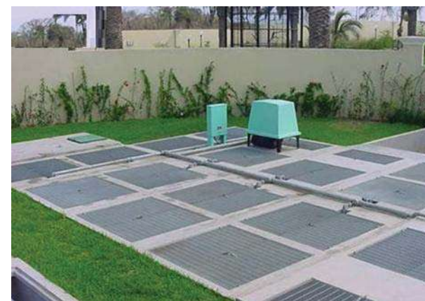
Imagen 71. Aspecto superficial de una planta de tratamiento instalada y funcional
