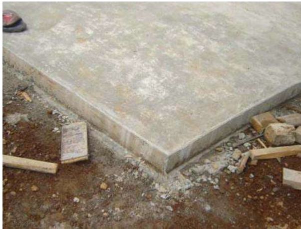
Imagen 52. Aspecto lateral de una placa de concreto de pavimentación
