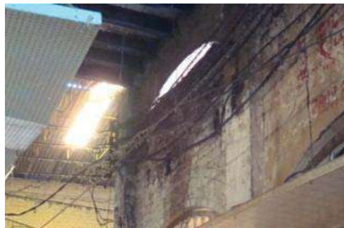
Fig.5: Cableado en mal estado con riesgo de incendio por corto circuito.
