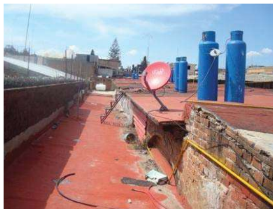
Fig.7: Instalación eléctrica y tuberías de gas muy próximas los cuales pueden ocasionar una explosión.
