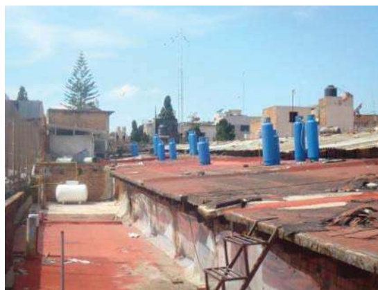
Fig.6: Azotea del mercado en mal estado donde se observa lo deteriorado de la losa y los cilindros de gas mal ubicados.
