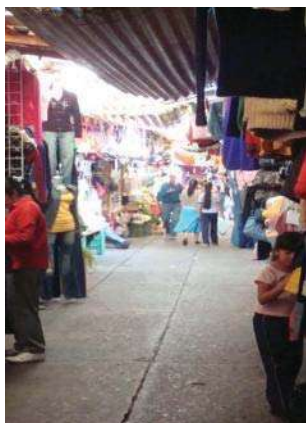
Fig.4: Problemas de aglomeración fuera del mercado donde se observan techos en muy mal estado.
