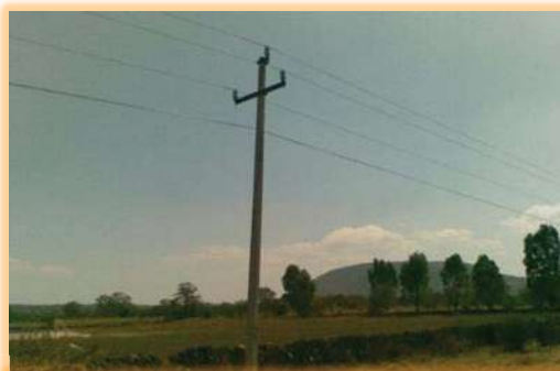
Imagen 38, Ubicación de los servicios de energía eléctrica. Fuente: J.C. García S. (20/04/11, 3:39 pm).
