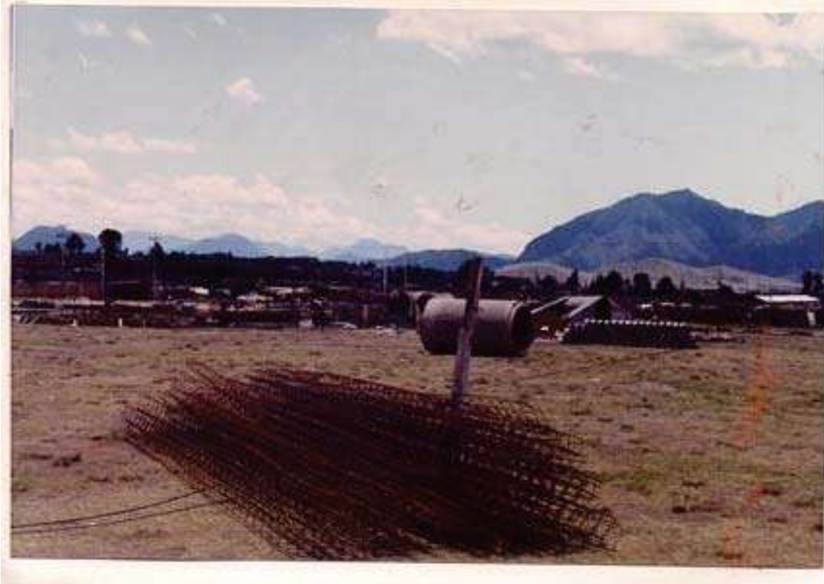
Ilustración 11.- Aspecto parcial del terreno donde se construyo el parque recreativo infantil (Fotografía tomada del material de construcción en el inicio de la misma)
