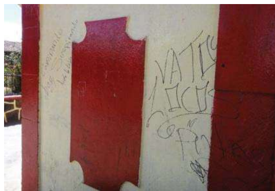
4/Kiosco de la plaza de San Andrés, se aprecia algunas marcas de vandalismo. /Fotografía tomada por la autora, 2010
