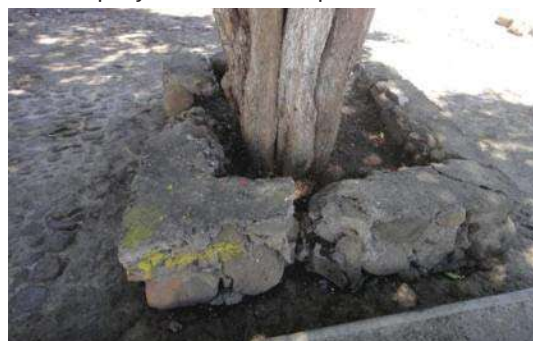
3/Guarnición de piedra para jardinera, en la plaza de San Andrés Tziróndaro, se observa que se encuentra fracturada/ Fotografía tomada por la autora, 2010
