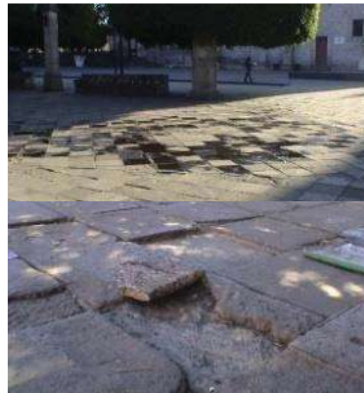
16/ Pavimentos, antes de la intervención/ despacho "Reprimich" 2004
