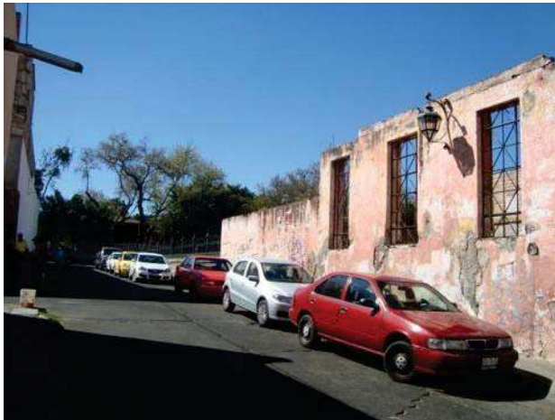
Imagen 17. Vista del terreno desde la calle Motolínia, se observa el estado de deterioro en que se encuentra la sección de barda perimetral que se localiza al oriente del terreno.
