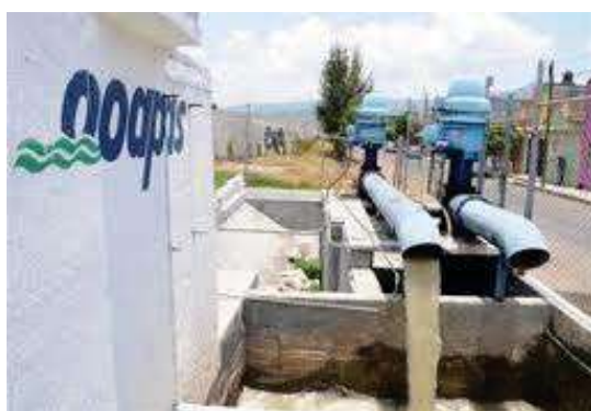
86. Infraestructura hidráulica. OOOAPAS
