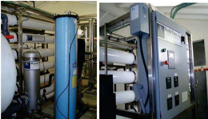
IMAGEN 66-67 Cuarto de Maquinas /Foto Edwin Flores
